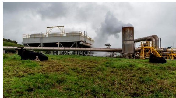
CENTRAL GEOTÉRMICA DO PICO VERMELHO NA ILHA DE SÃO MIGUEL © SIARAM
